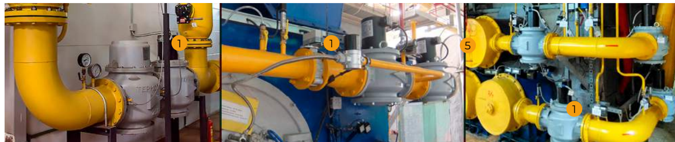
1 Контроль срабатывания предохранительно-запорного клапана 1-2 МПа индуктивные датчики
